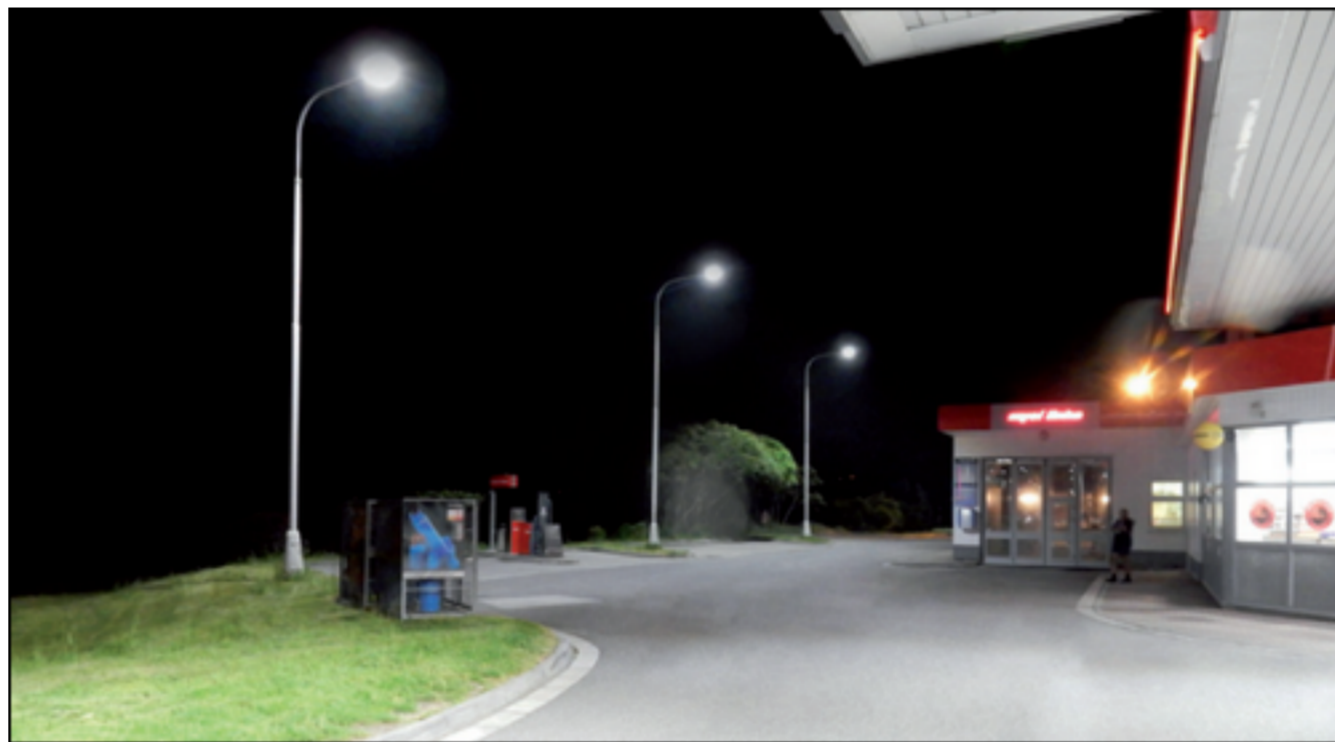
Obr. 3. Komplexní výměna osvětlení na čerpací stanici Benzina Hořice – 90 W LED svítidla veřejného osvětlení Lumbio svítí ve výšce 8,5 m v barvě denního světla; výborná viditelnost a věrnost podání barev zvyšují bezpečnost, bledost a přesnost v prostorech, kde je ostrážitost rozhodující; osvětlení LED svítidly umožňuje také plynulou regulaci a automatizaci, s jejichž pomocí je možné osvětlenost během určitých hodin snížit nebo naopak zvýšit na plný výkon (v době zvýšeného provozu)
